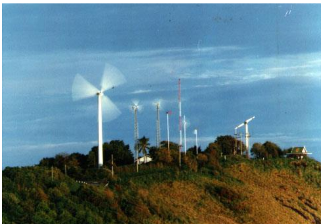
ภาพที่ 2.6 สถานีผลิตไฟฟ้าจากพลังงานลมร่วมกับระบบเซลล์แสงอาทิตย์ ของการไฟฟ้าฝ่ายผลิต ที่แหลมพรหมเทพ จังหวัดภูเก็ต ที่มา (Siripuekpong et al. 2002 : 58)
